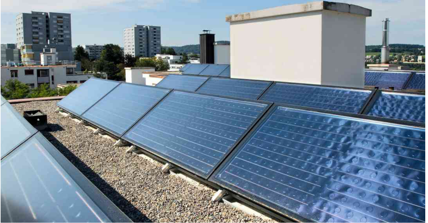
Solarwärme-Anlage: aufgeständerte Kollektoren auf Flachdach. (Anlagen-Foto: Solarline-Güttinger AG)
