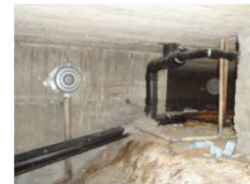
F.5 Ventilatore radiale-centrifugo inserito nella parete del vespaio
